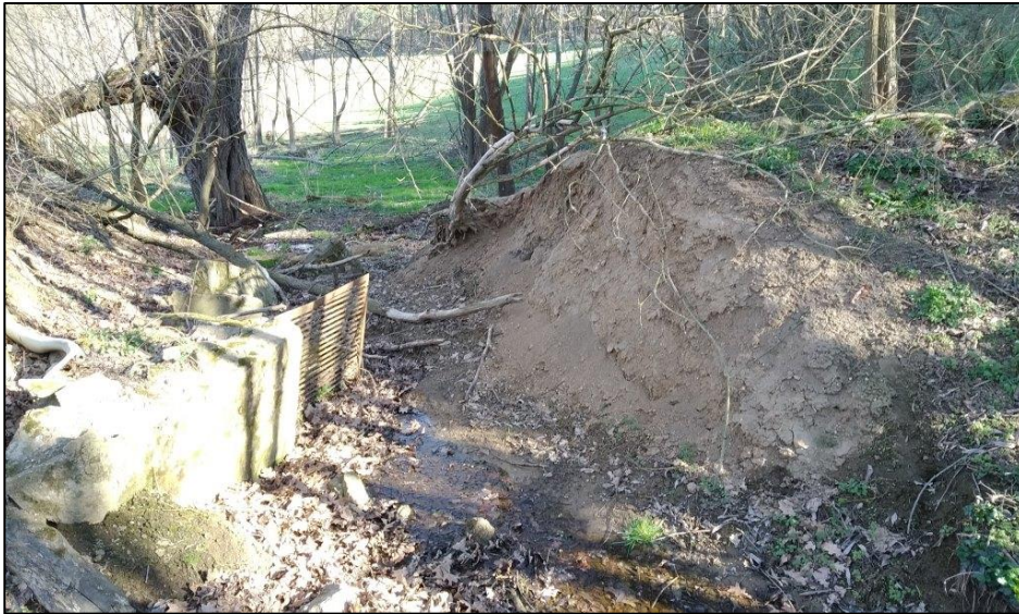
Foto 1: Zbytky protržené původní hráze
