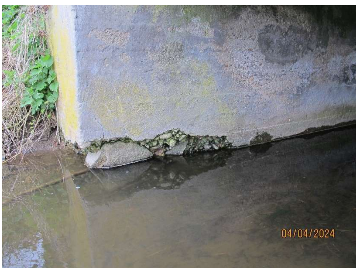
Kaverny v betonu na pravé straně opěry O1. Nevhodná velikost kameniva betonu.
