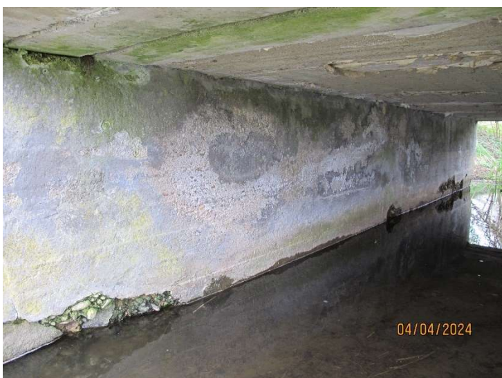
Pohled na opěru O1. Patrné stopy po zatékání v místě uložení krajních nosníků na opěru.
