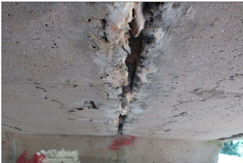
2. pole - stopy po průsaku sparou mezi prefabrikáty v úrovni příčle rámu
