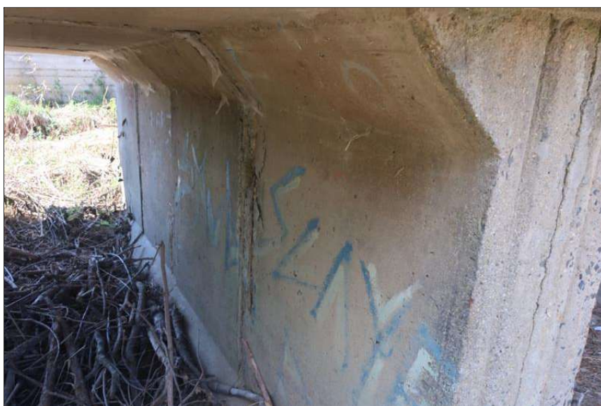
na stěně rámu P3 ve 3. poli jsou v oblastech nedostatečné tloušťky krycí vrstvy obnažené pruty korodující výztuže
