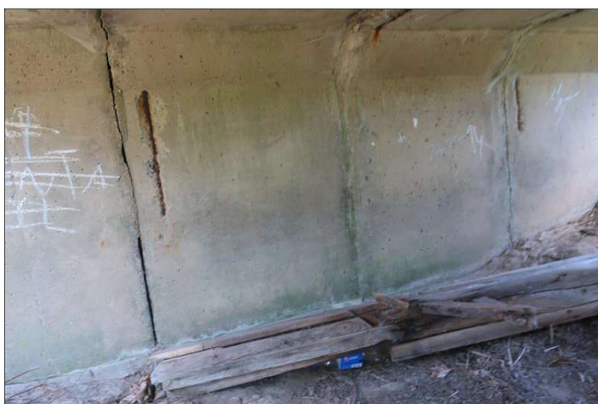
na stěně rámu O1 v 1. poli jsou v oblastech nedostatečné tloušťky krycí vrstvy obnažené pruty korodující výztuže
