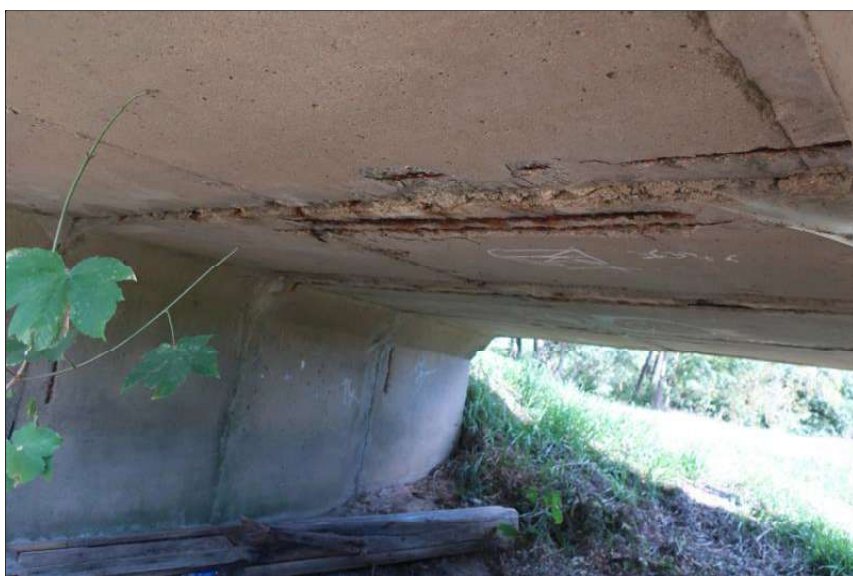
na spodním lici příčle rámu v 1. poli jsou v oblastech nedostatečné tloušťky krycí vrstvy obnažené pruty korodující výztuže
