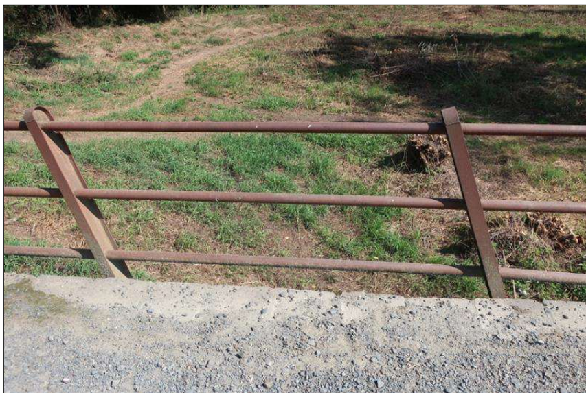
levé zábradlí je výrazně deformované
