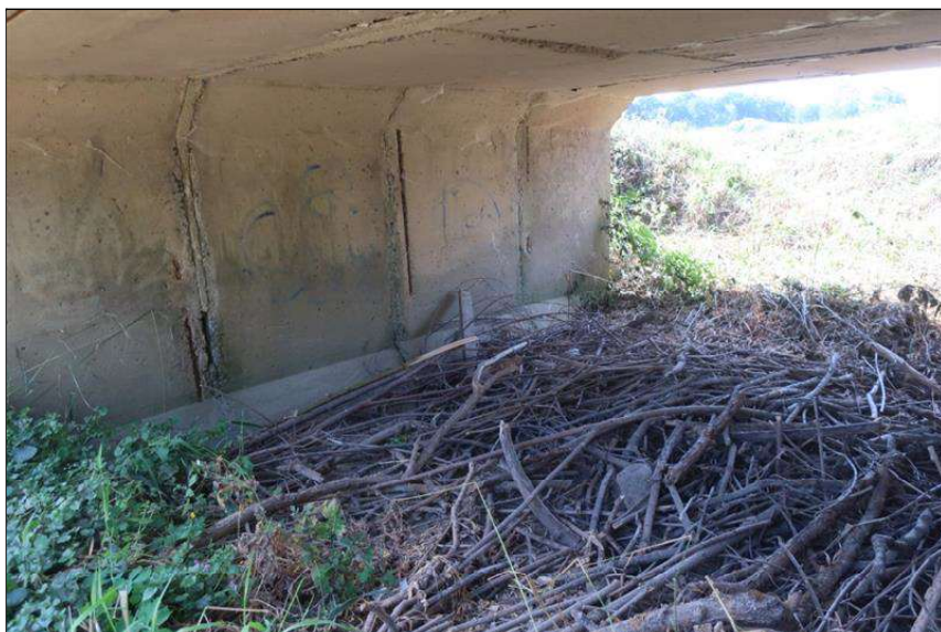
v mostním otvoru 3. pole jsou naplaveniny na stěně rámu O4 jsou v oblastech nedostatečné tloušťky krycí vrstvy obnažené pruty korodující výztuže
