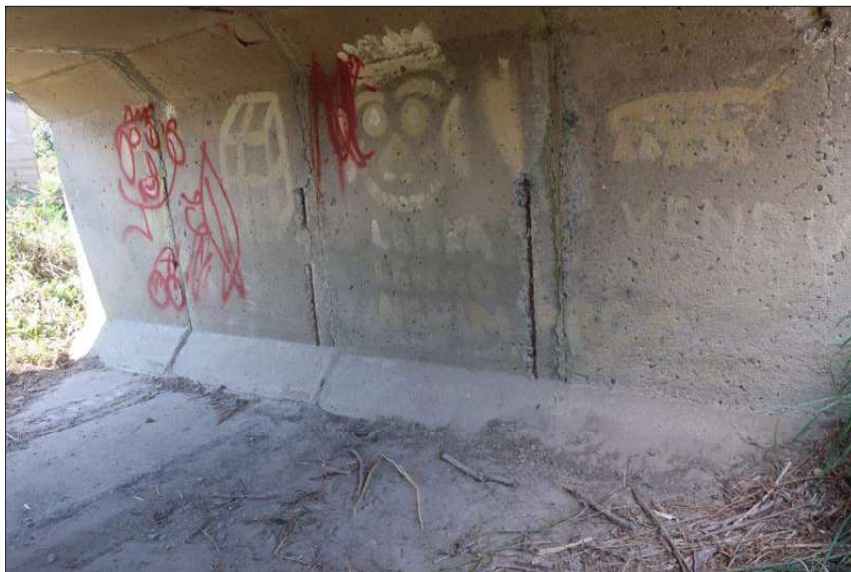
na stěně rámu P3 ve 2. poli jsou v oblastech nedostatečné tloušťky krycí vrstvy obnažené pruty korodující výztuže
