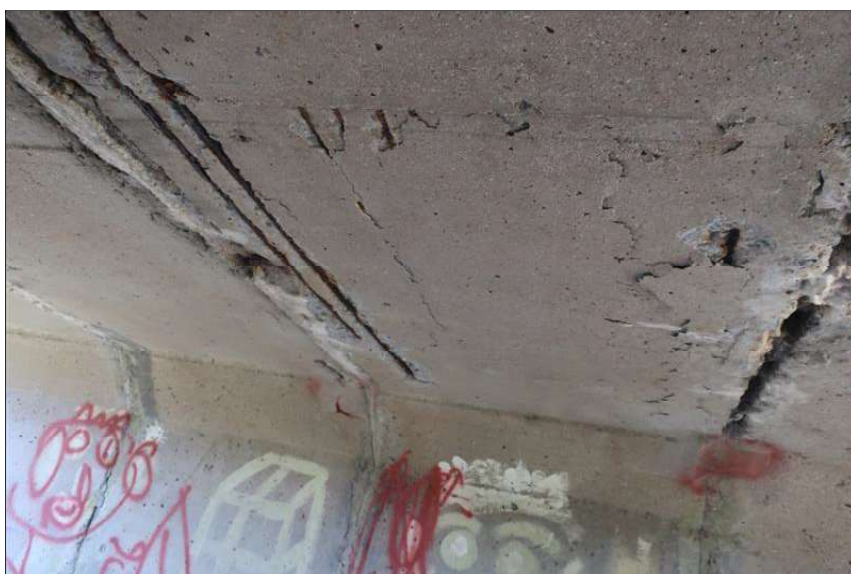
na spodním lici přičle rámu ve 2. poli jsou v oblastech nedostatečné tloušťky krycí vrstvy obnažené pruty korodující výztuže dochází k separaci krycí vrstvy nad korodující výztuží
