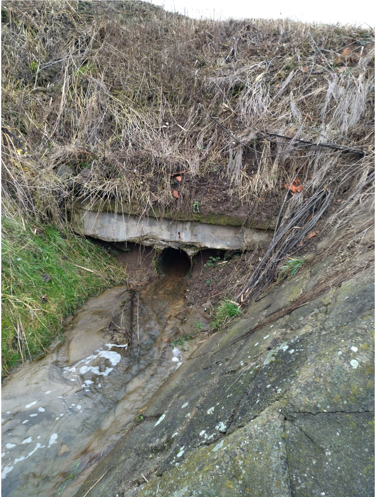
výtokové potrubí na vzdušné straně hráze
