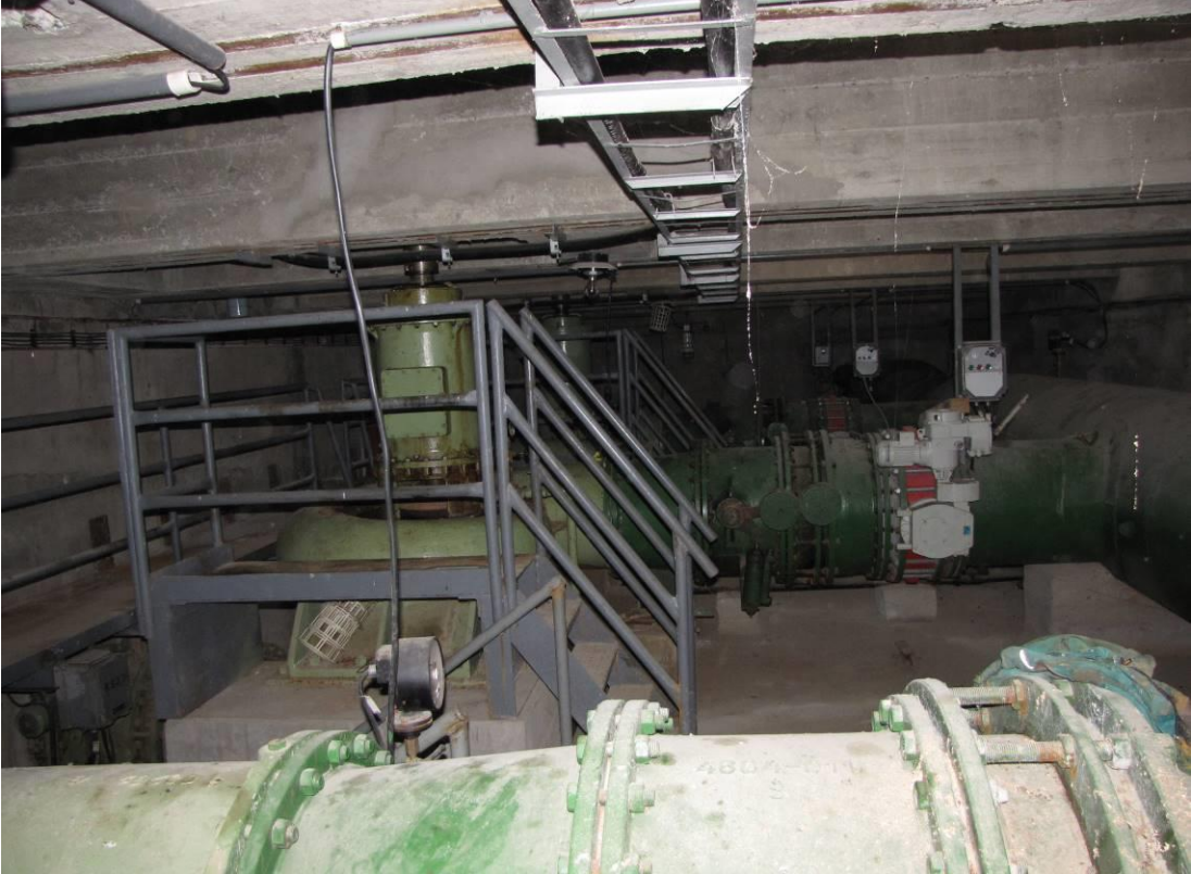
Strojovna - podzemní část ČSP 1
