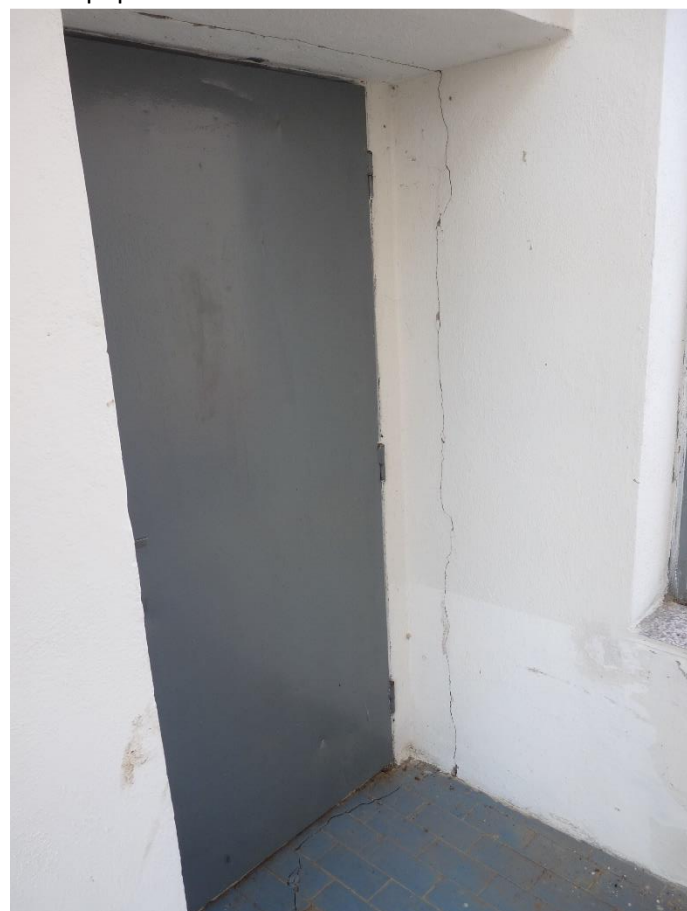
Detail popraskaného zdiva
