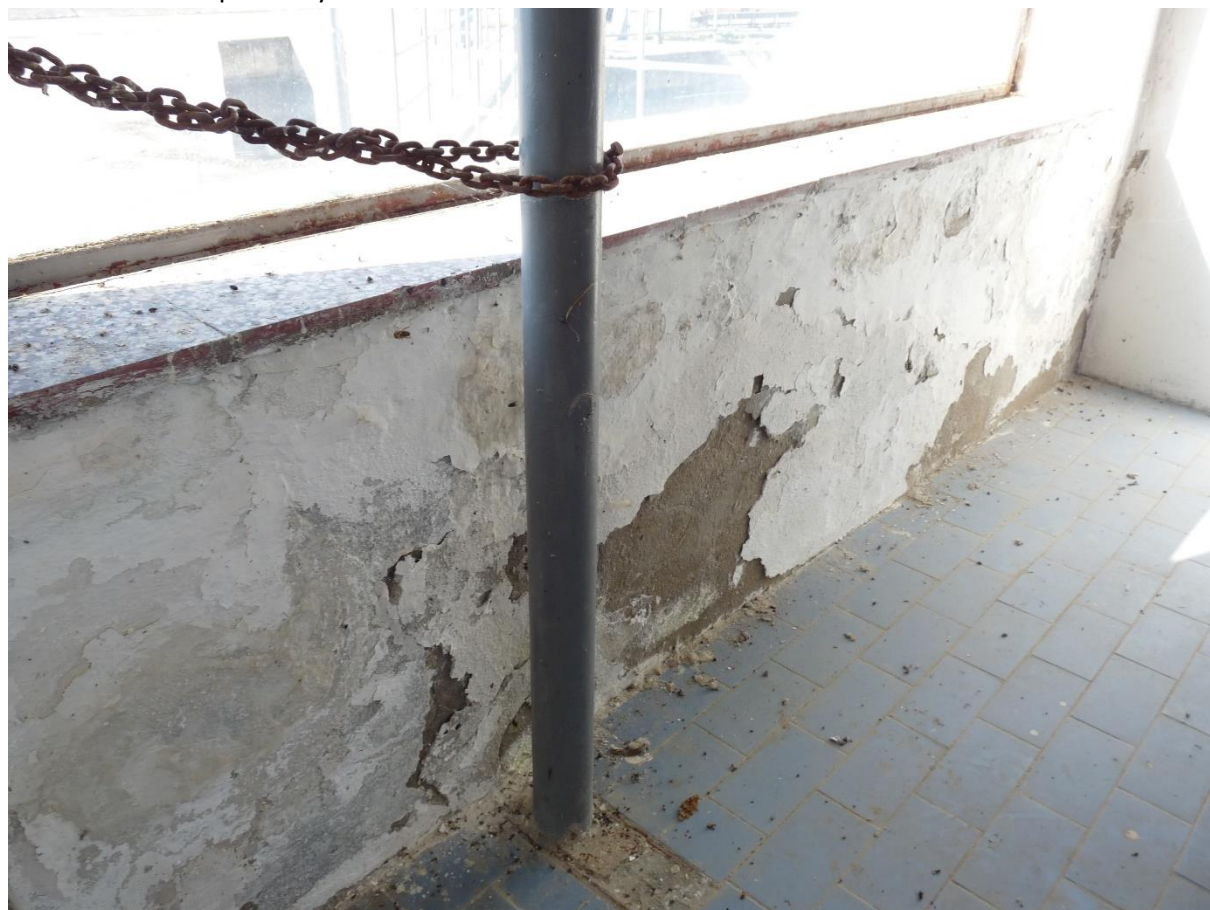
Detail navlhlé zdi pod okny
