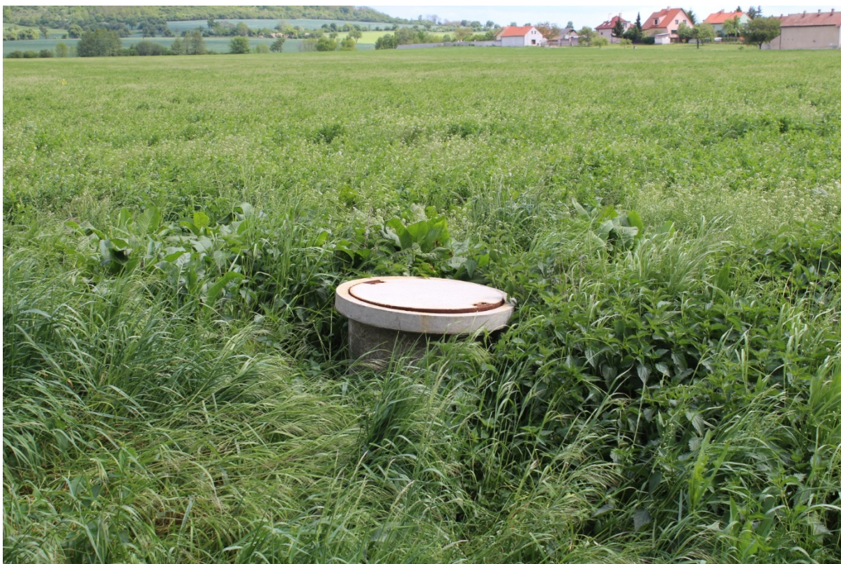
Obr. 11. Drenážní šachtice v k.ú. Vražkov
