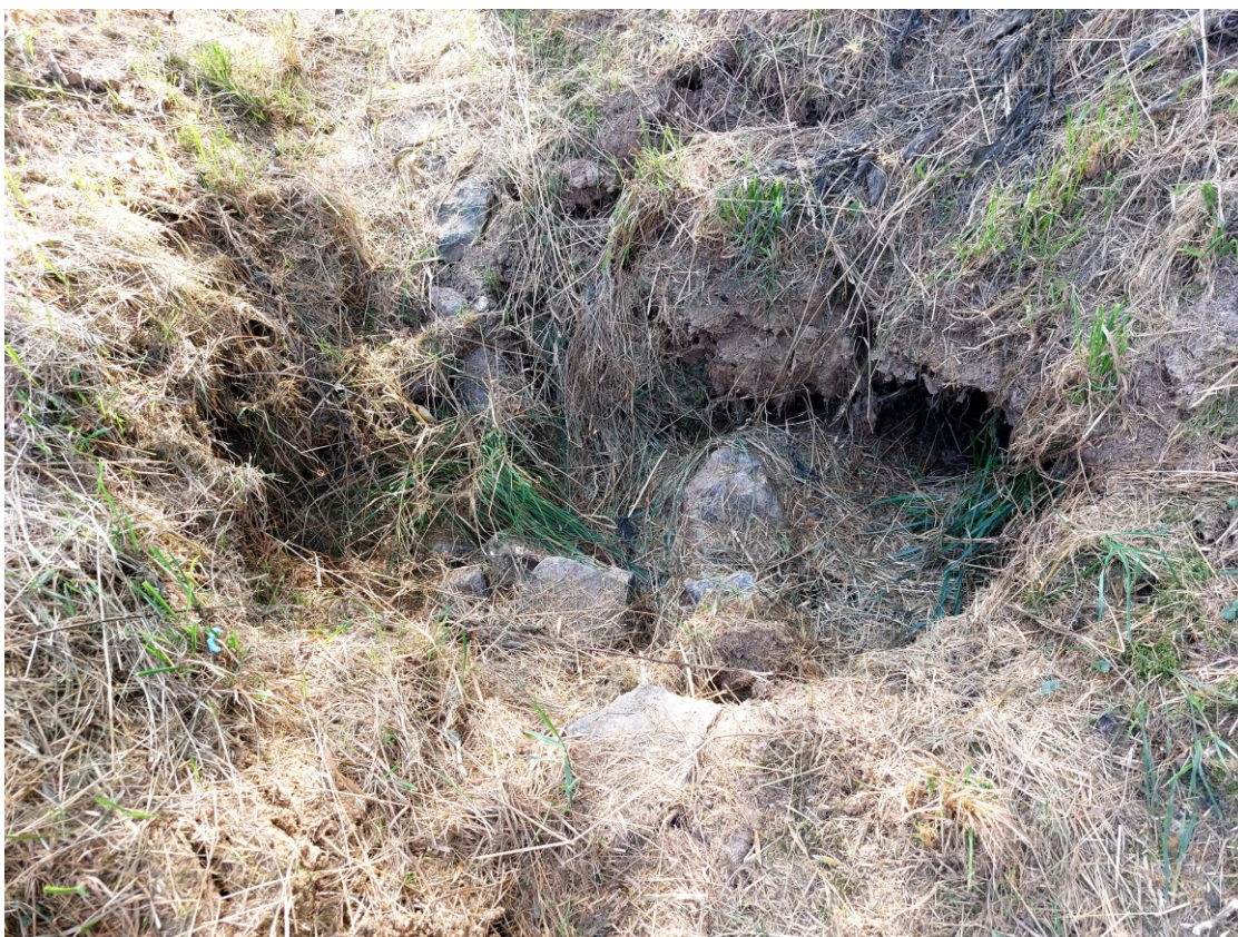
Propadlé dno – detail
