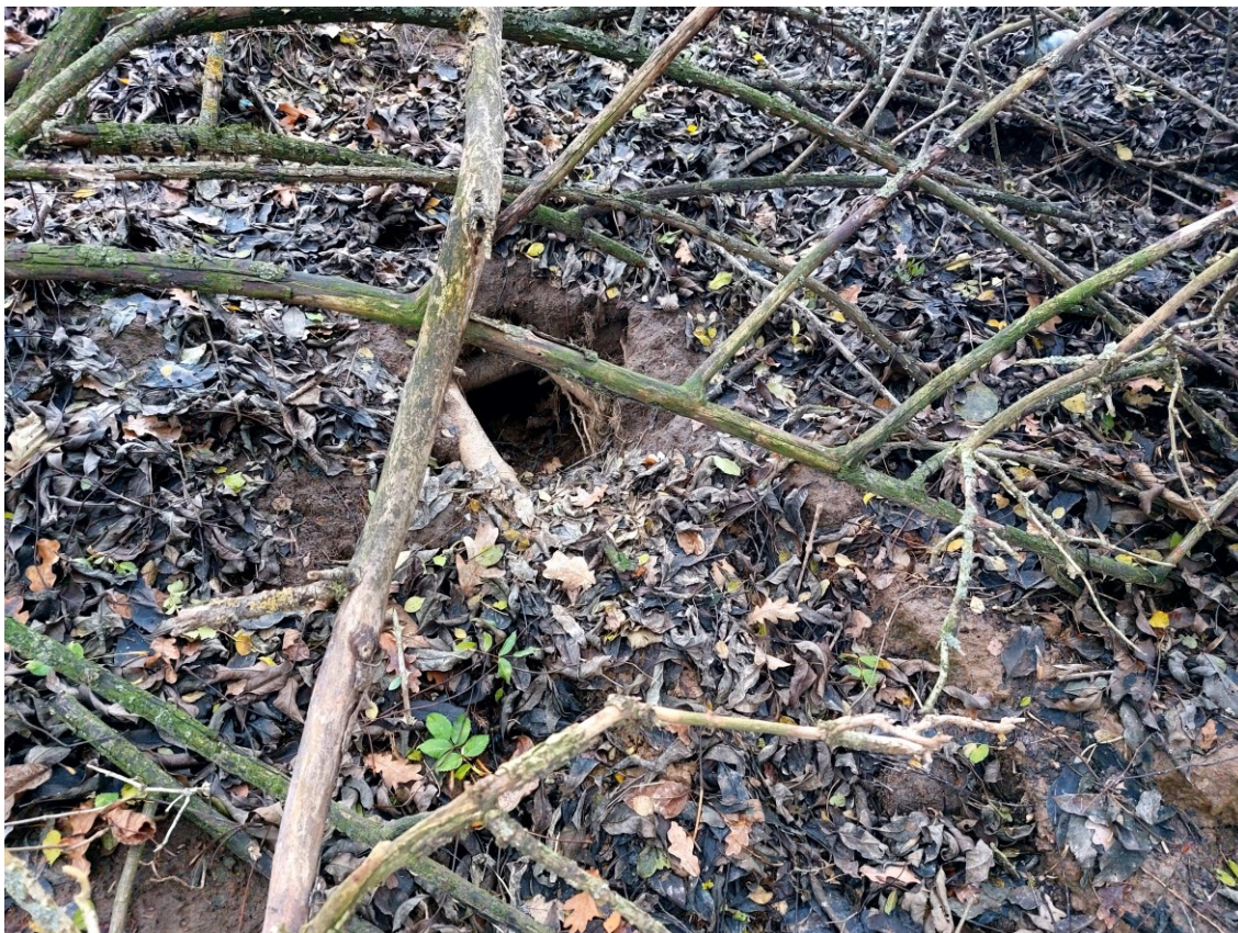
Nora s vyplavenou zeminou v prostoru pod HOZ
