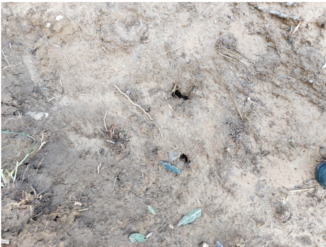
Opětovné propadávání zahrnutého místa
