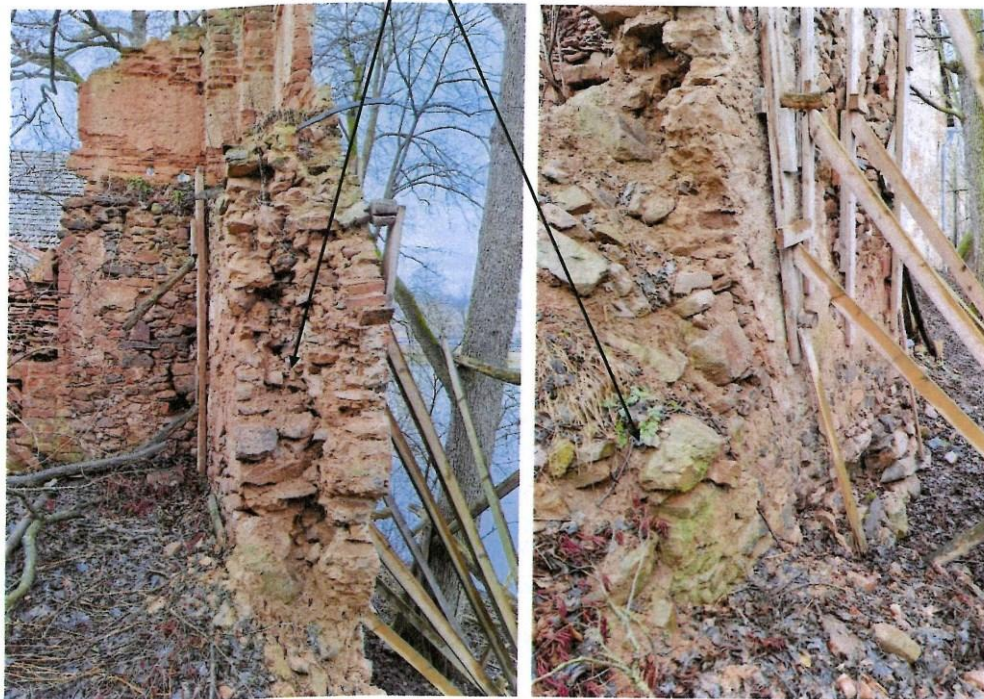
Tvrz Lhotice – torzo bašty - aktuální zhodnocení stávajícího stavu stavby, nástin nezbytných záchranných prací. 3.2024
