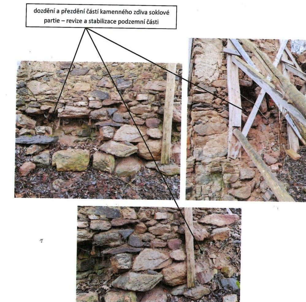
Tvrz Lhotice – torzo bašty - aktuální zhodnocení stávajícího stavu stavby, nástin nezbytných záchranných prací. 2024
