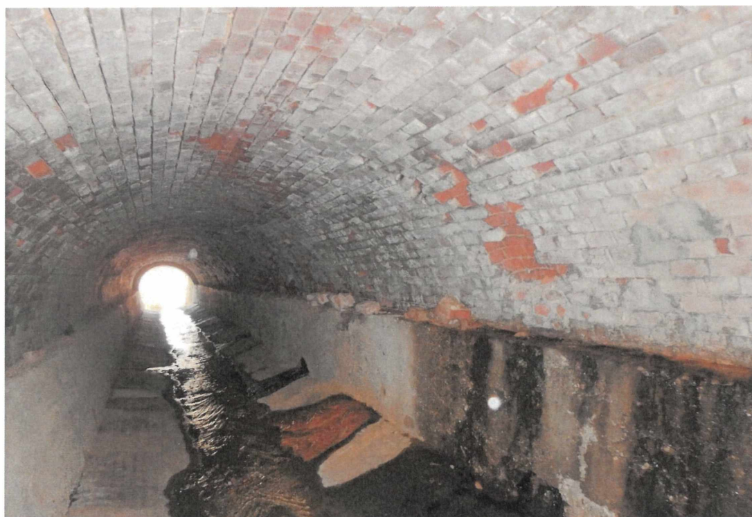
Obr. 4 – Trvalé výrony vody, největší z pravé strany chodby
