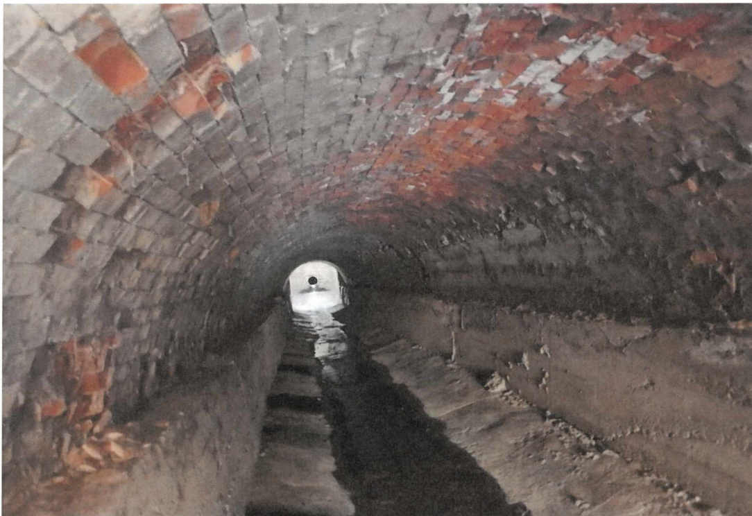
Obr. 5 – Pokračující rozpad cihlového zdiva klenby chodby
