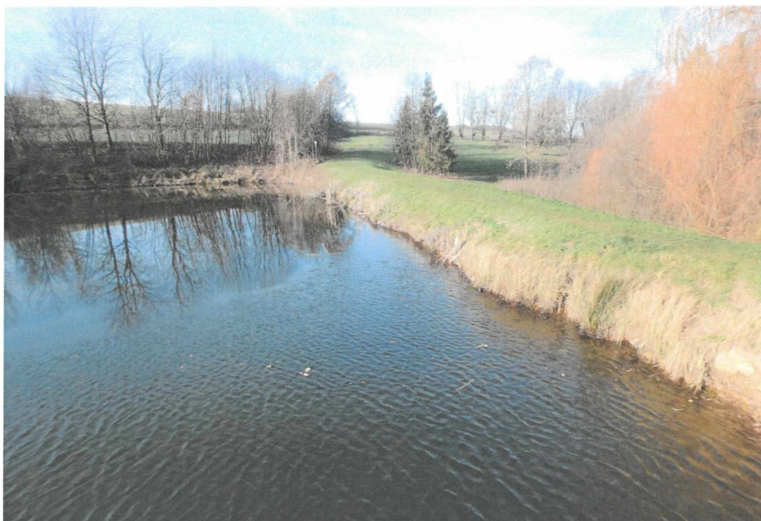
Obr. 2 - Poškozen opevnění návodního svahu
