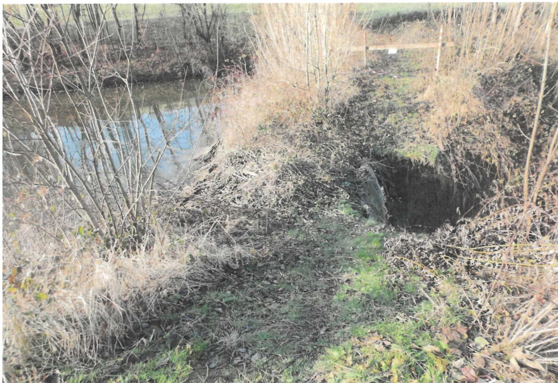
Obr. 3 – Poškození přelivné hrany bezpečnostního přelivu
