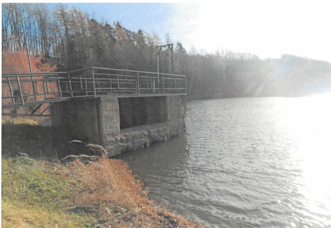
Obr. 2 – Rozpad betonů sdruženého objektu
