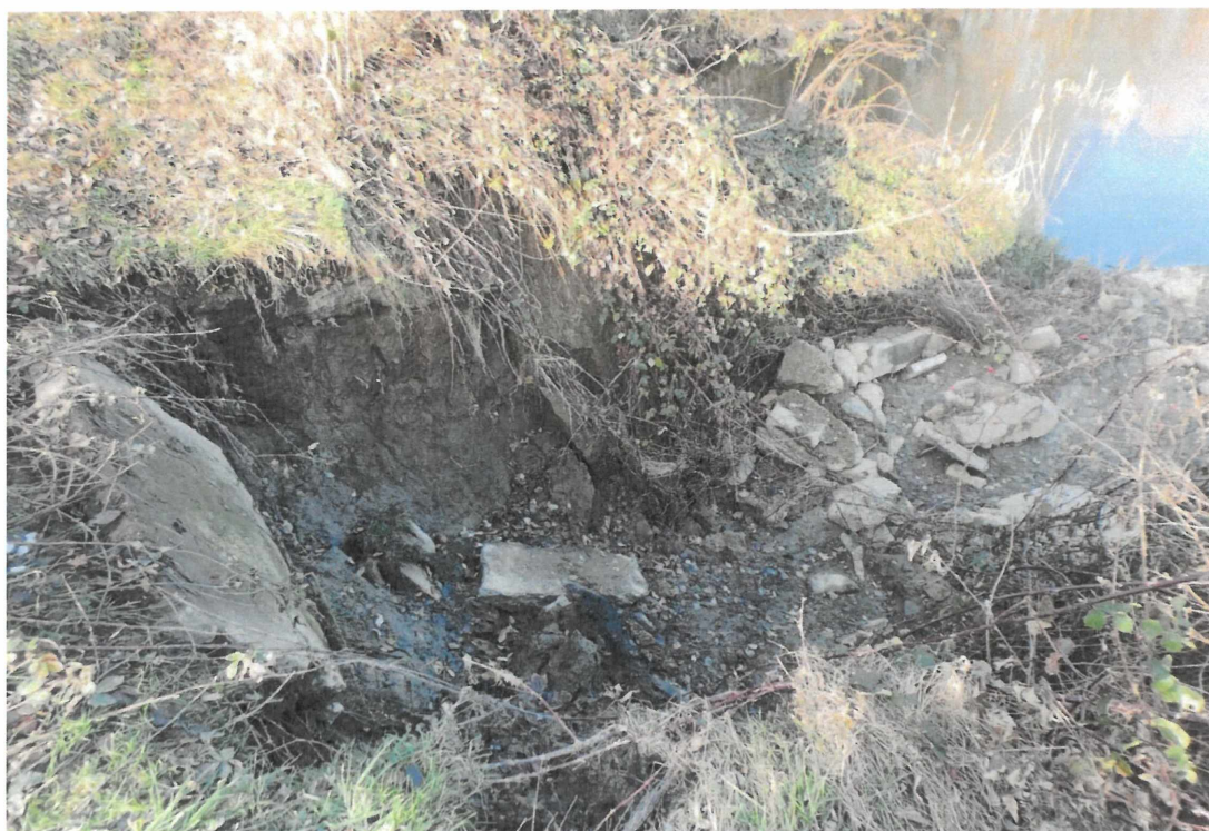
Obr. 4 – Odplavené opevnění skluzu
