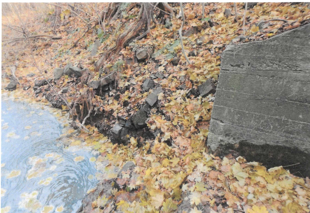
Obr.6 – Výron vody z pravé strany podél rubu zdiva chodby
