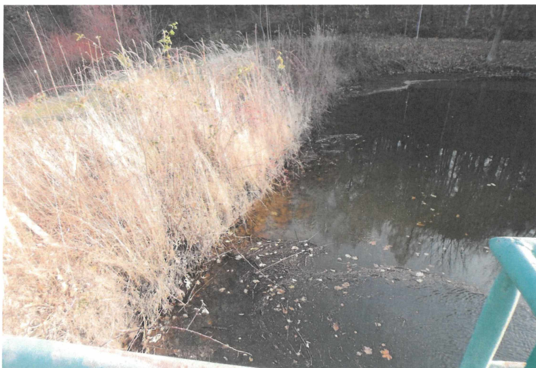
Obr. 2 - Poškozené opevnění návodního svahu
