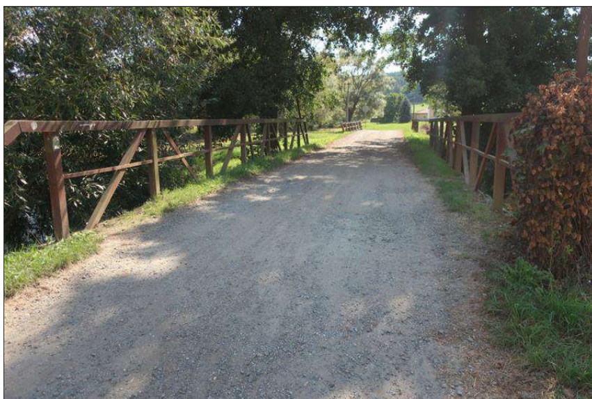
nezpevněný kryt vozovky
