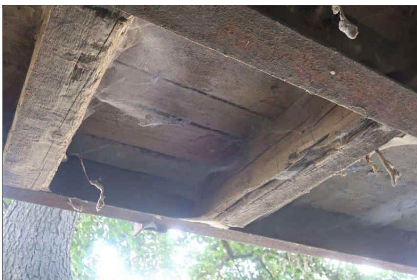
část podhledu mostovky ve 2. poli je dosud zabetonována z doby stavby
