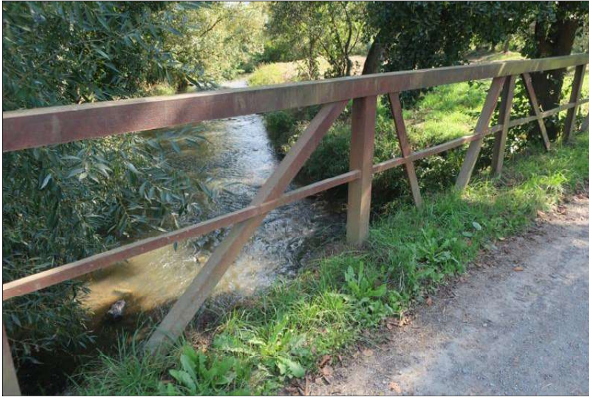
zarostlá krajnice koroze zábradlí
