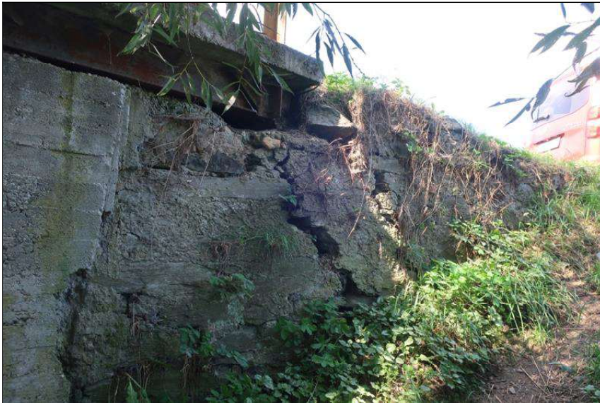
rozpad betonu levého křídla opěry O1
