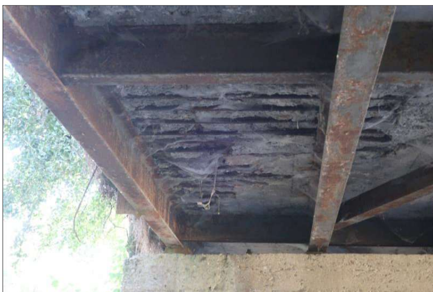
hloubková degradace betonu desky mostovky nad pilířem P2 výrazná koroze nosné výztuže desky se zásadním oslabením její průřezové plochy
