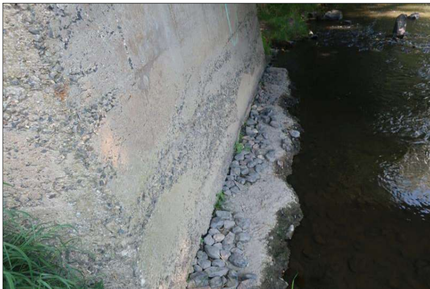
hloubkově degradovaný základový ústupek opěry O1
