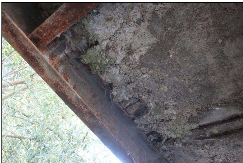
hloubková degradace betonu desky mostovky výrazná koroze nosné výztuže desky se zásadním oslabením její průřezové plochy
