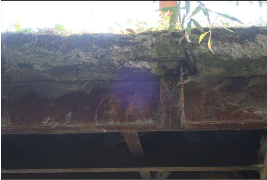
hloubkový rozpad betonu na levém boku desky v 1. poli
