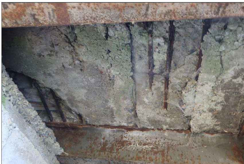
hloubková degradace betonu desky mostovky nad opěrou O1 výrazná koroze nosné výztuže desky se zásadním oslabením její průřezové plochy
