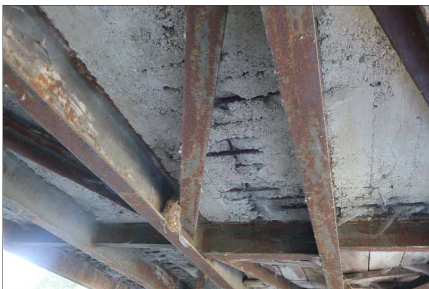
hlubková degradace betonu desky mostovky v 1. poli výrazná koroze nosné výztuže desky se zásadním oslabením její průřezové plochy koroze ocelových nosníků
