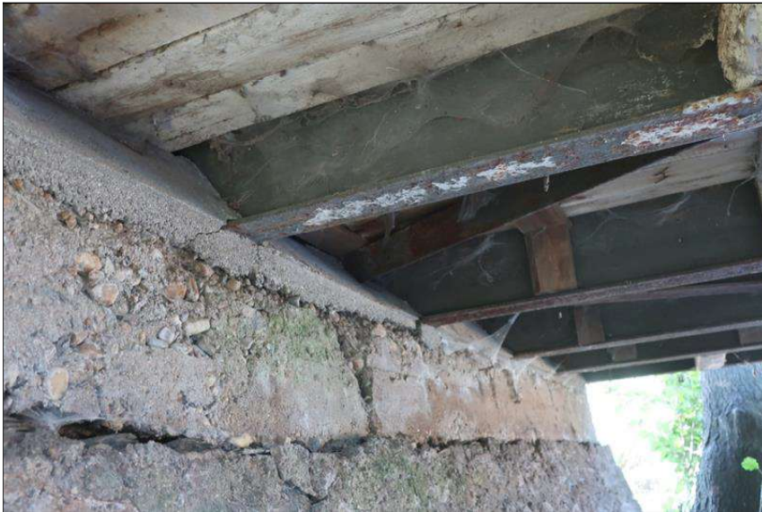
rozpadající se beton úložného prahu O3
