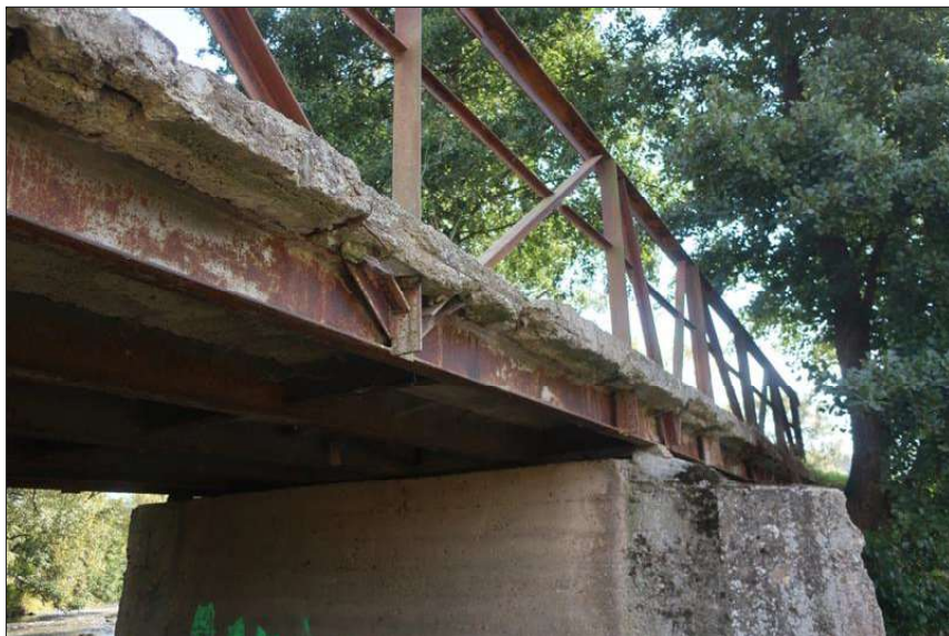
hloubková degradace betonu pravého boku desky v 1. poli
