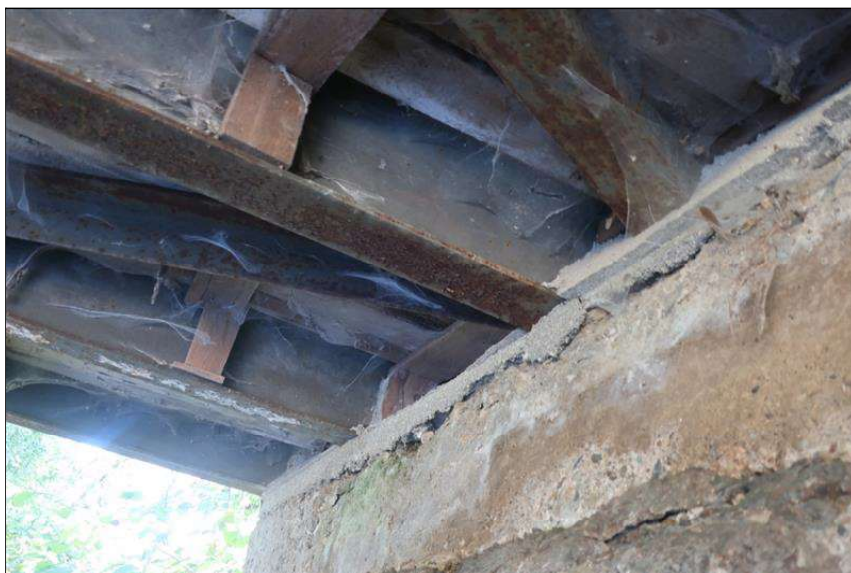
hloubková degradace betonu úložného prahu opěry O3
