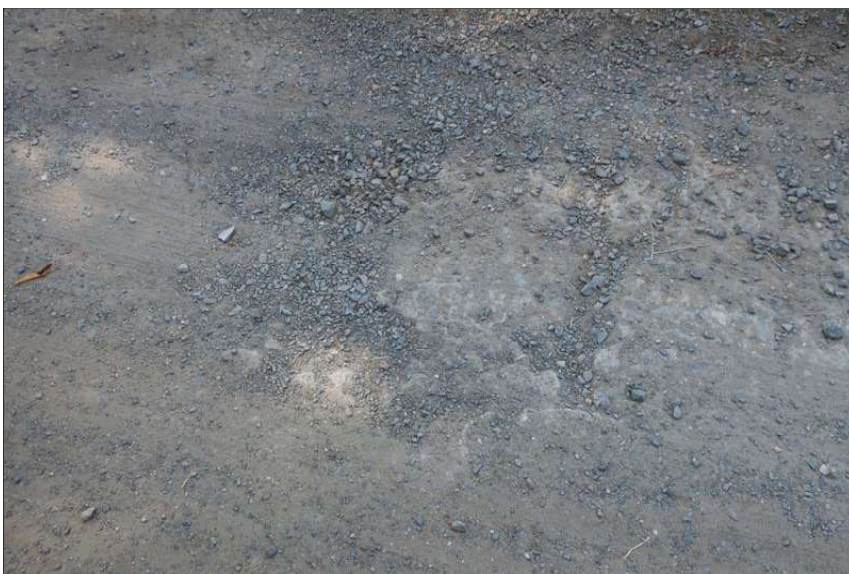
v krytu vozovky jsou patrné deformace
