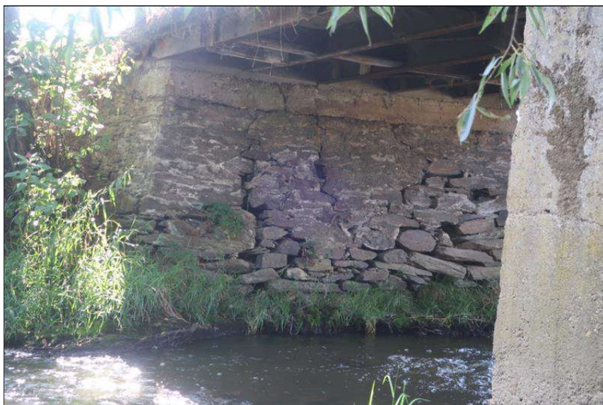
rozpad zdiva dřiku a betonu úložného prahu opěry O3
