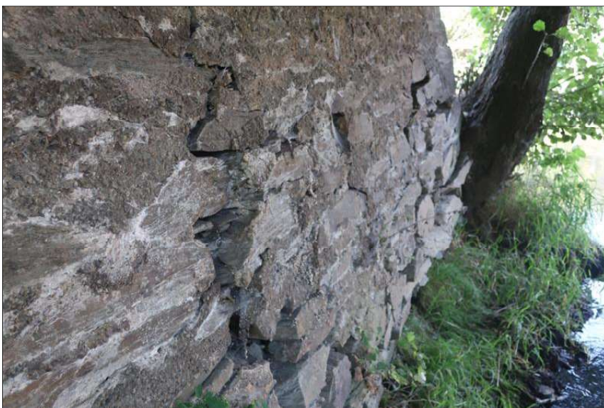
výrazná deformace zdiva na líci dřívku opěry O3
