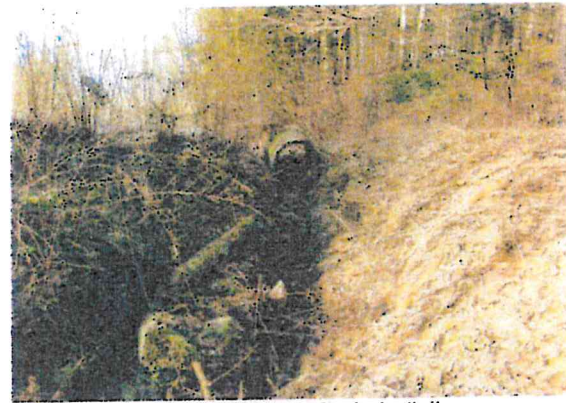
betonová trouba DN 600 ve funkci přelivu
