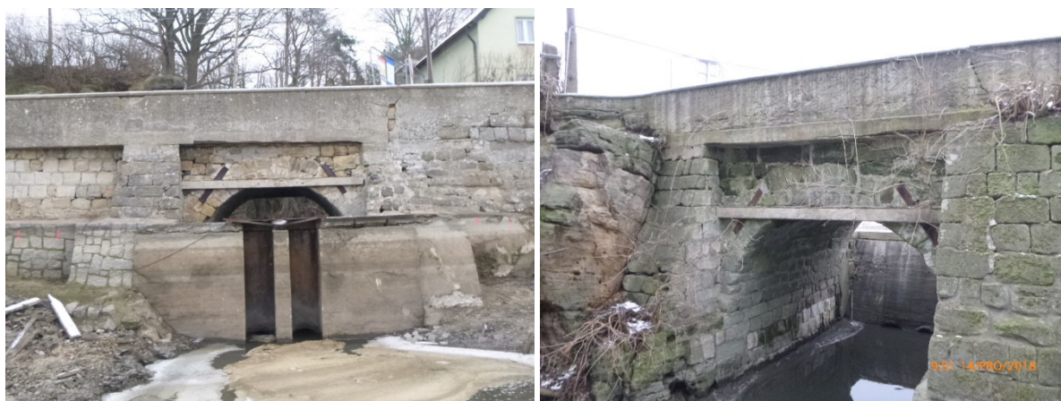
Obrázek 7 – Pohled na nosnou konstrukci z návodní strany (vlevo) a povodní strany (vpravo)
