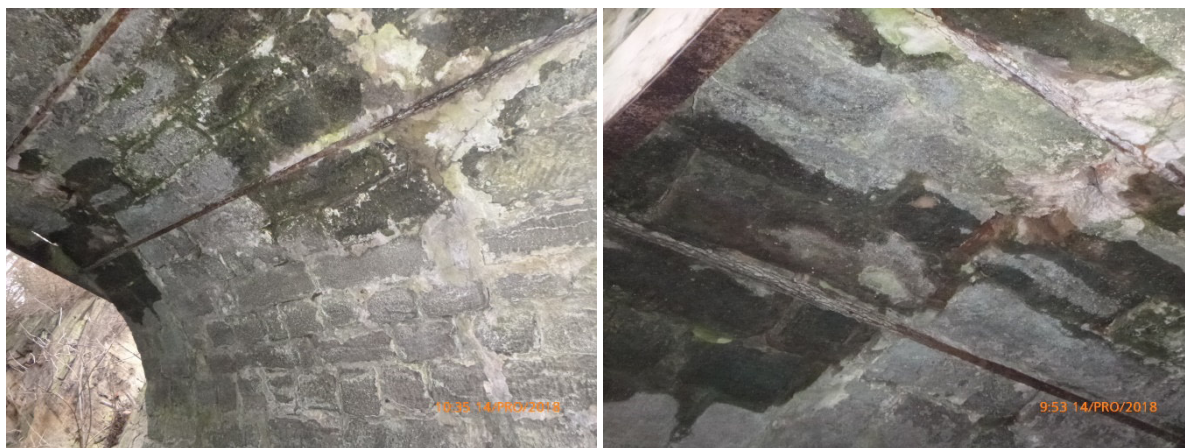
Obrázek 8 – Stav nosné konstrukce (zatékání, degradace zdiva) a detail podélné trhliny a koroze ocelových táhel
