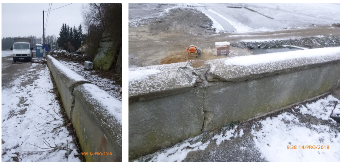
Obrázek 11 – Poškození vozovky a parapetní zdi trhlinami a vykloněním zdi v oblasti mostu
