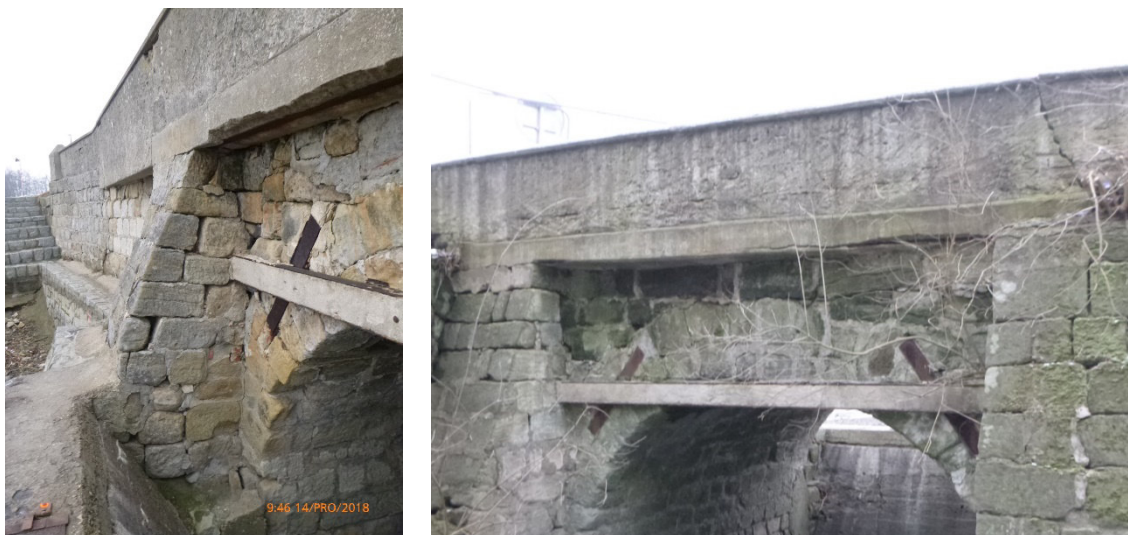
Obrázek 9 – Poškození čelních zdí na návodní (vlevo) a povodní (vpravo) straně mostu
