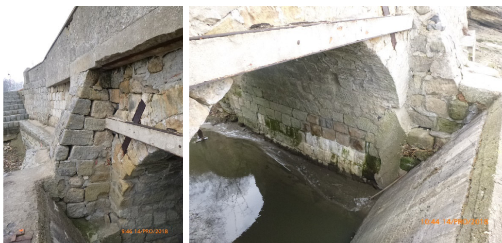
Obrázek 6 – Rozvolnění zdiva zesilujících pilířů na návodní straně mostu, stav zesílení klenby
