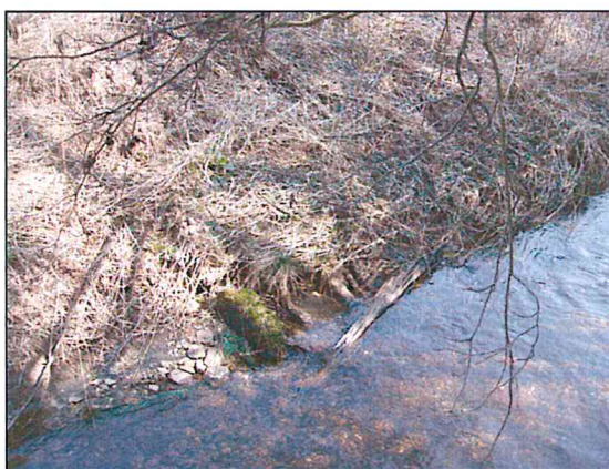
T. drenážní kameninová trubka DN 200, vyúst'uje z levého břehu
