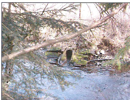
F. vyústění příkopu, který podchází cestu betonovou troubou DN 600, nad tímto křížením je otevřený příkop
