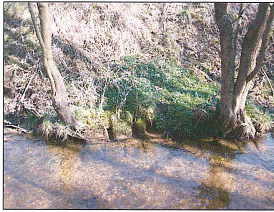
P. eternitová trouba DN 150, porušená, průtok čisté vody
