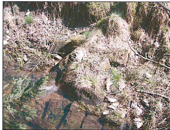
Q. dvojice prefabrikovaných betonových vyústění drenáže, malý průtok železité vody, obě jsou mírně poškozené, je cítit kanalizace
