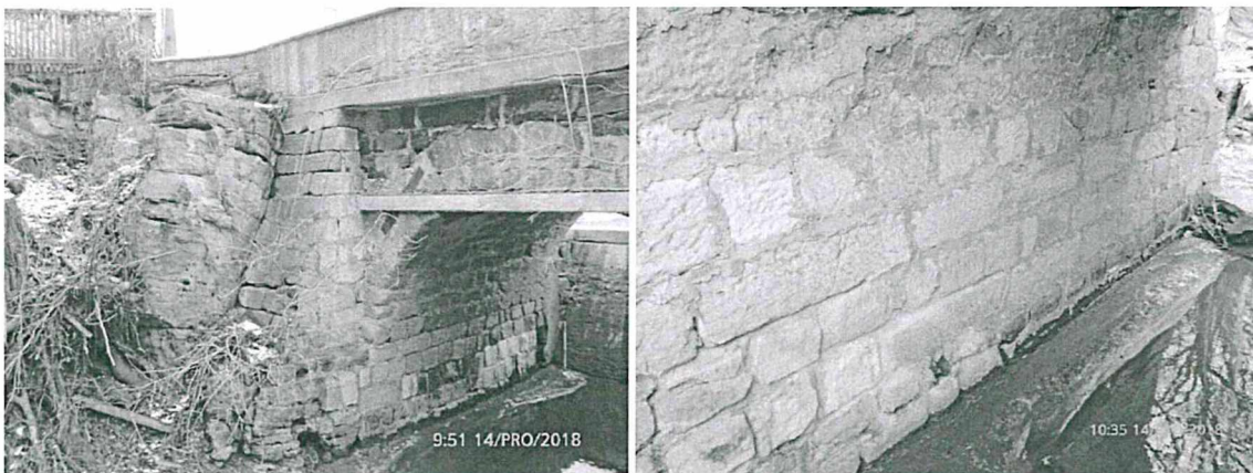
Obrázek 4 – Stav opěr mostu a navazujících křídel (vlevo opěra 2, vpravo opěra 1)
