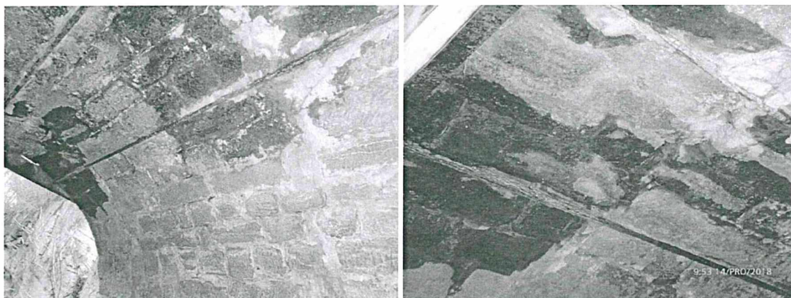
Obrázek 8 – Stav nosné konstrukce (zatékání, degradace zdiva) a detail podélné trhliny a koroze ocelových táhel
