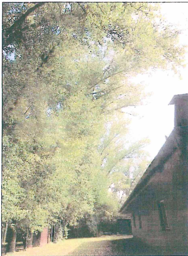
Větve okrajových stromů převěšené nad střechu budovy
